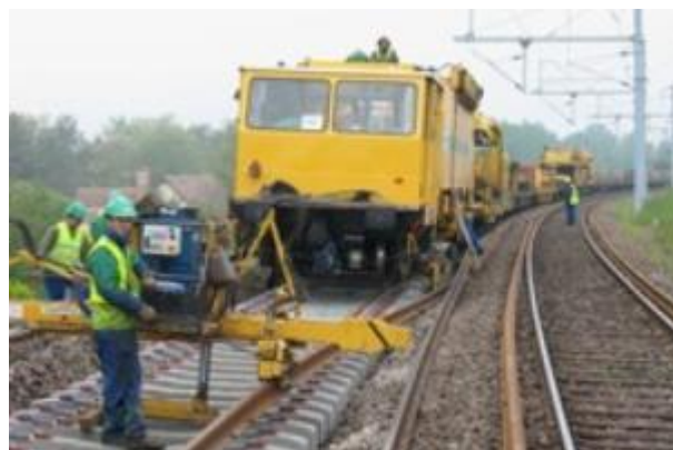
Longs Rails soudés sur traverses béton
